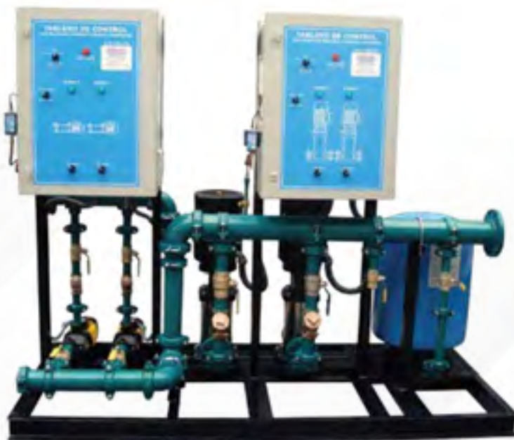
Equipo de bombeo triplex
